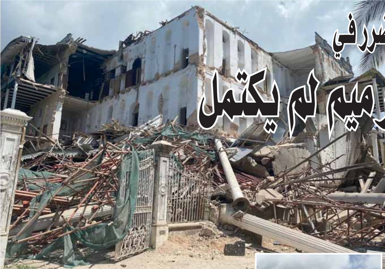
■ مشهد يوضح الانهيار الجزئي الذي لحق بالمبنى
