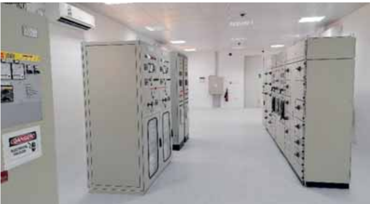
■ المشروع يعد من ضمن مشاريع توسيع وتطوير الشبكة الكهربائية في محافظة الظاهرة
