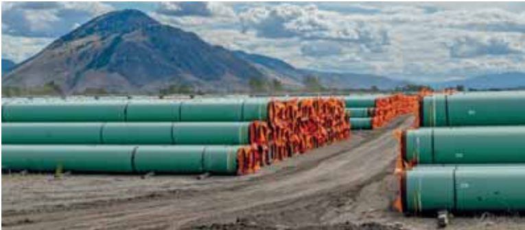
■ أنابيب فولاذية يراد استخدامها في بناء خط أنابيب النفط لمشروع التوسع عبر الجبال التابع للحكومة الكندية، يقع في موقع للتخزين في كاملوبيس، الصورة التقطت أمس الأول الثلاثاء.
