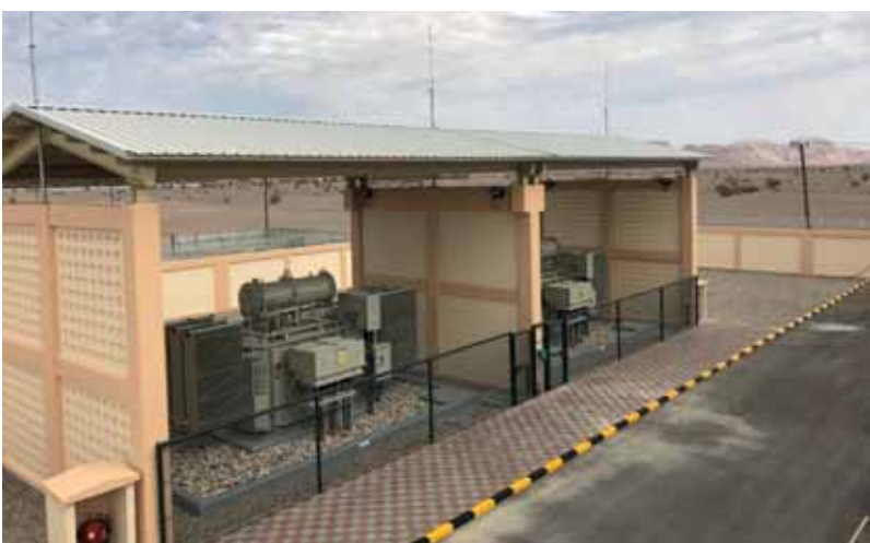
■ محطة محولات مجز تم تنفيذها وفق معايير الأمان والجودة
