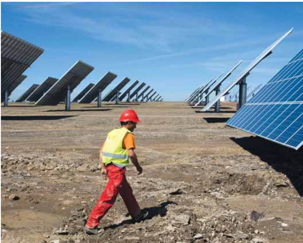
■ عامل يمشي بين الألواح الشمسية في محطة لتوليد الكهرباء جنوب البرتغال، حيث يقوم عدد من المستثمرين من القطاع الخاص ببناء المحطة.
