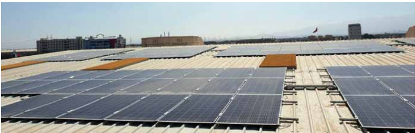
■ محطة الطاقة الشمسية تغذي احتياحات المدرسة من الكهرباء
