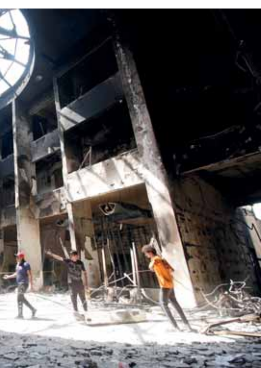
■ عمال ينظفون مبنى محافظة البصرة بعد أن احرقه المتظاهرون
