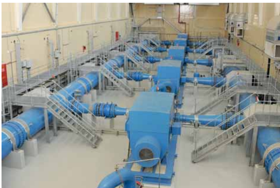
■ محطة الضخ الرئيسية بقريات
