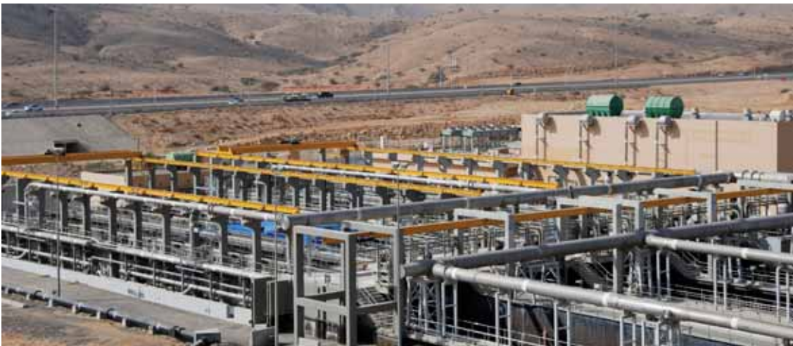
■ محطة معالجة مياه الصرف الصحي بغلا
