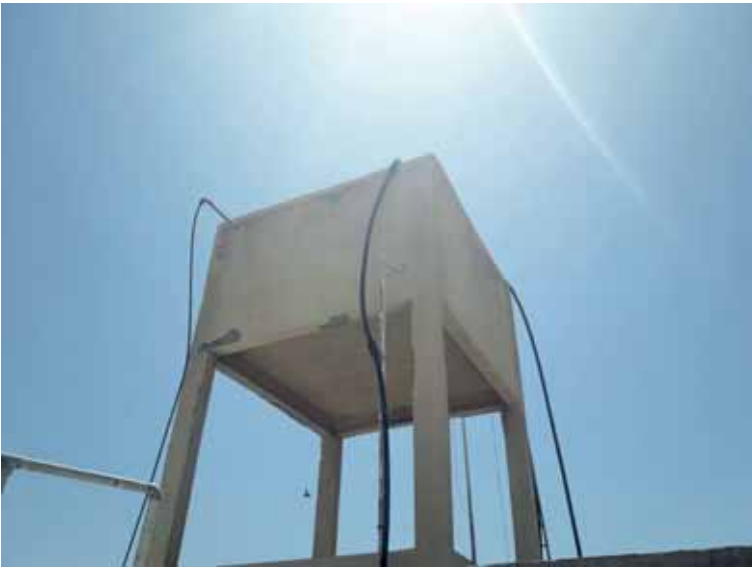
■ خزان المياه الذي يغذي المنطقة بالمياه
