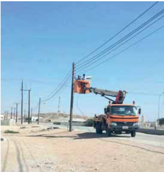
■ فحص مجمعات المشغلات الآلية والأرضية لأعمدة الإنارة في الطرق الداخلية والتجمعات السكنية
