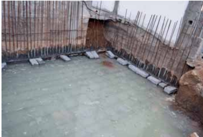
■ أحد المنازل قيد الإنشاء امتلأ بالمياه أثناء الحفر والبناء .. وهو نموذج لحجم الضرر
