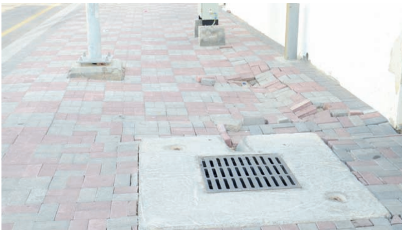
■ الصورة توضح الحاجة الماسة الى اعادة النخل في مسالة تصريف مياه الامطار لتأثيرها على ارصفة المنازل
