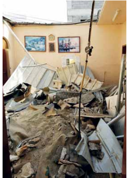
■ صورة توضح انهيار السقف بالمنزل
