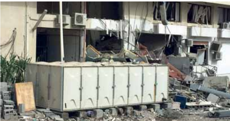
■ أضرار بالغة في المبنى نتيجة الانفجار
