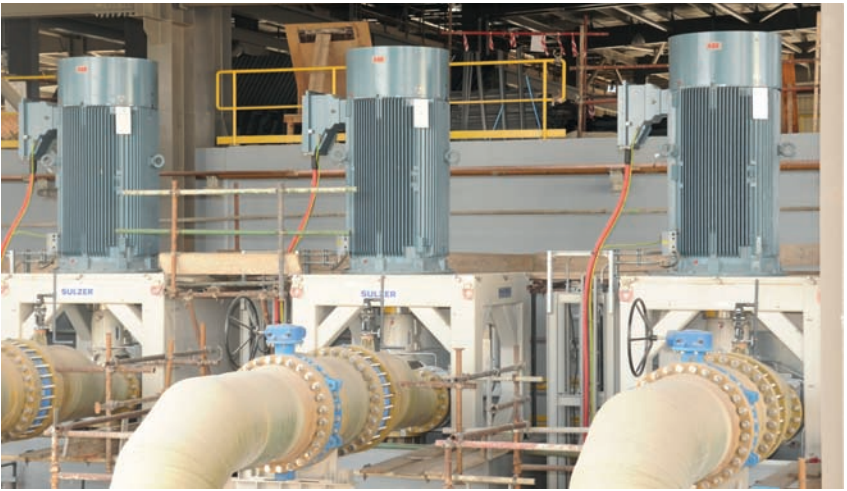
■ محطة الغبرة لتلحلية المياه
