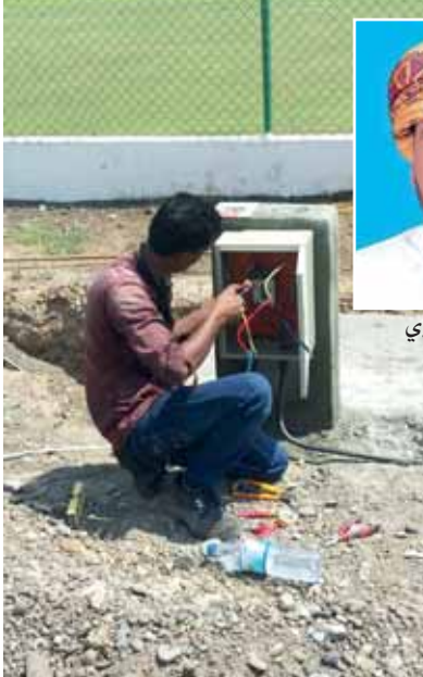
■ تجهيز إنارة الملعب
