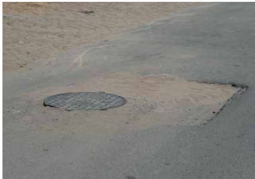
■ حفر واضحة بعد توصيل احدى الخدمات
