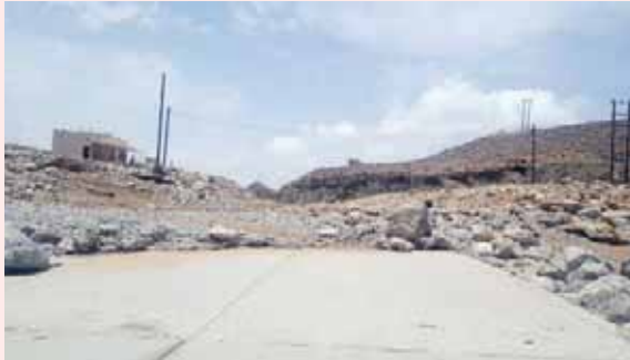
■ تضرر الطرق بشكل جسيم
