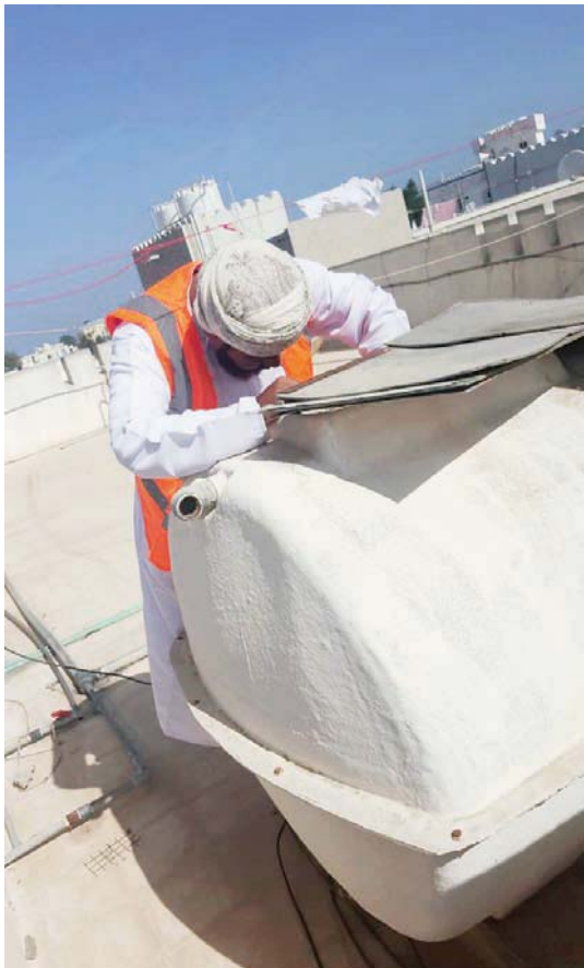
■ متابعة خزانات المياه
