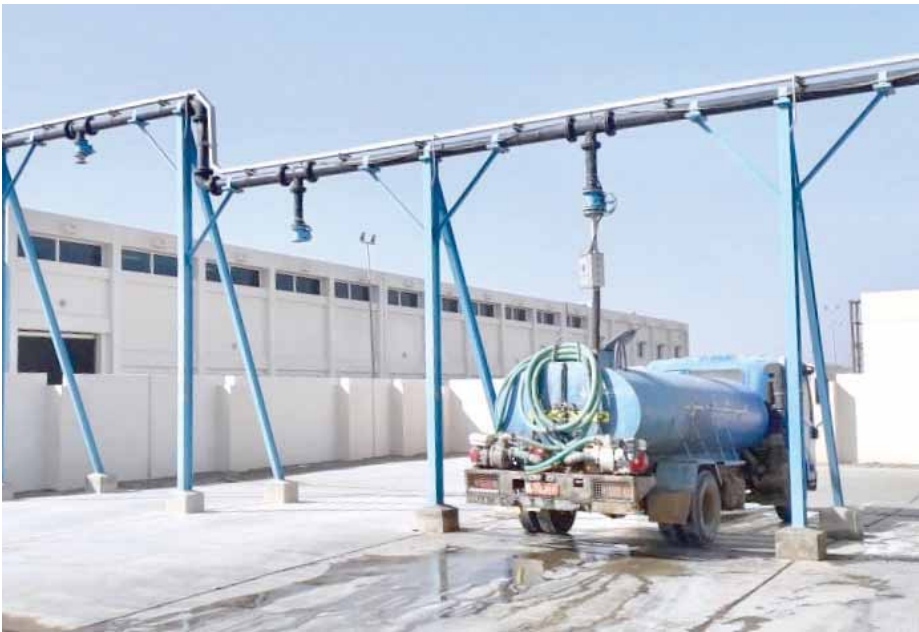
■ محطة تعبئة ناقلات المياه
