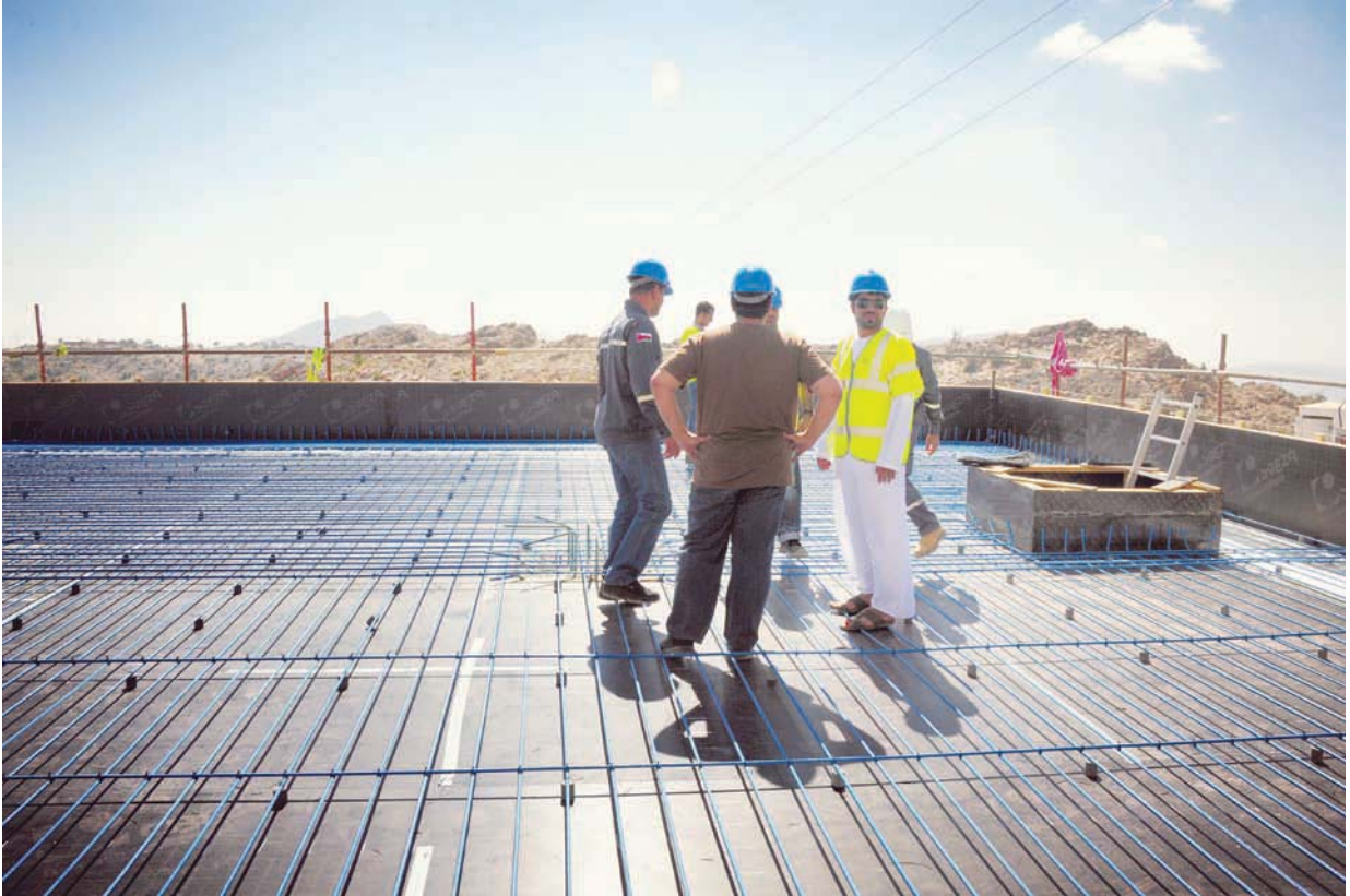
■ من زيارة «عمان» لمحطة نيابة الجبل الأخضر
