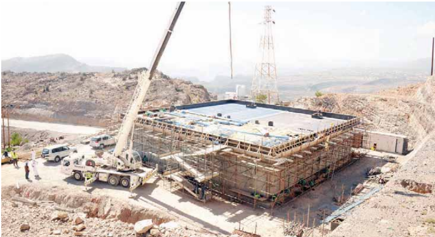
■ أحد خزانات المياه الجاهزة للتشغيل
