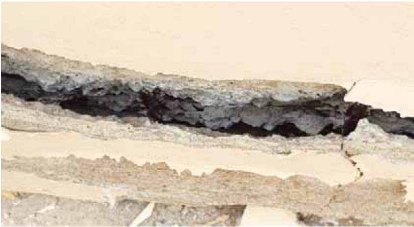
هذا البناء لم يتجاوز عمره خمس سنوات وتبدو التشققات واضحة
