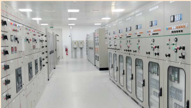
■ محطة توزيع الكهرباء مزودة بأحدث الأجهزة والأنظمة الكهربائية
