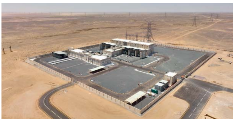
■ المشروع يربط شبكة النقل الرئيسية بشبكة كهرباء ظفار
