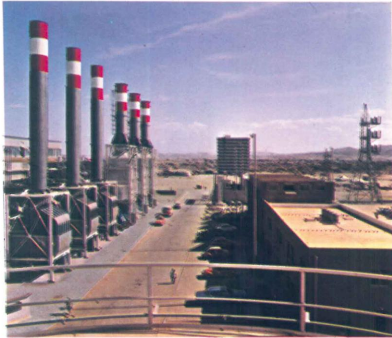
محطة تحلية المياه وتوليد الكهرباء بالغبرة
