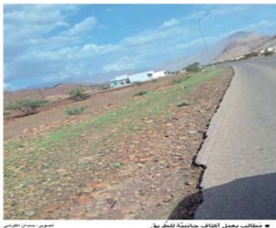
■ مطالبات بمعالجة الحفر وتشققات الطريق
