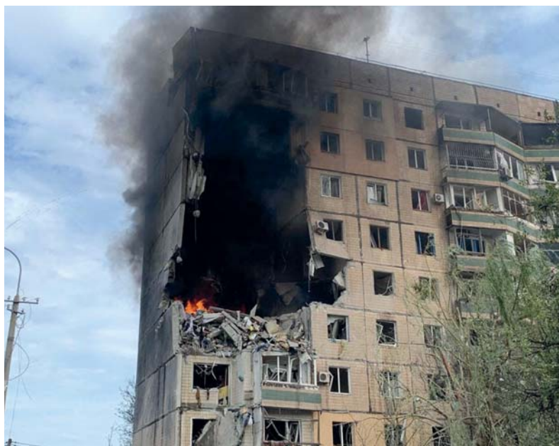
■ مبنى سكني من تسعة طوابق دمر جزئياً نتيجة ضربة صاروخية روسية في كريفى ريغ.
