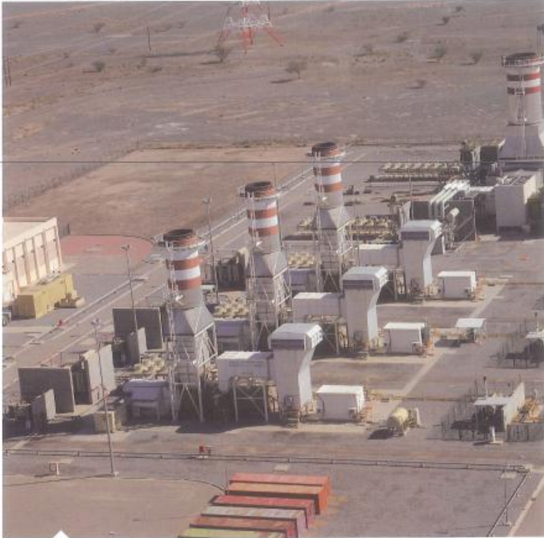
محطة توليد الطاقة الكهربائية بولاية متح.
