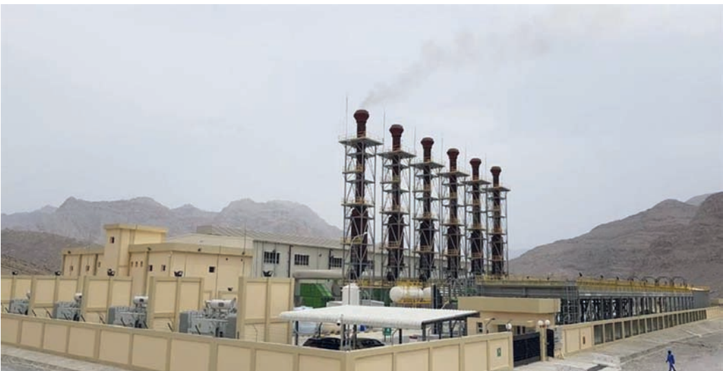
محطة كهرباء خصب الجديدة تهدف لتأمين الطاقة الكهربائية الاحتياطية للمشتريين
