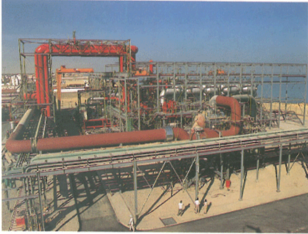
▲ توسعات في محطة توليد الكهرباء وتحلية المياه بالغبيرة.
