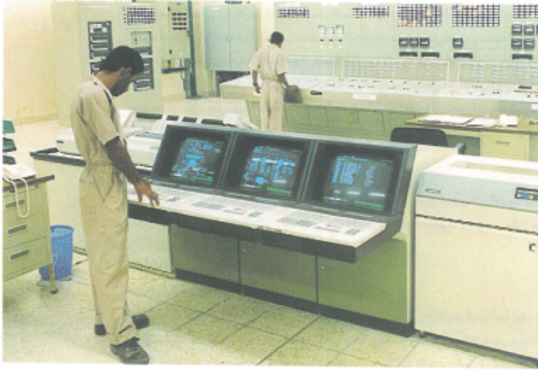
▲ غرفة التحكم الرئيسية بمحطة تحلية المياه بالغبرة.
