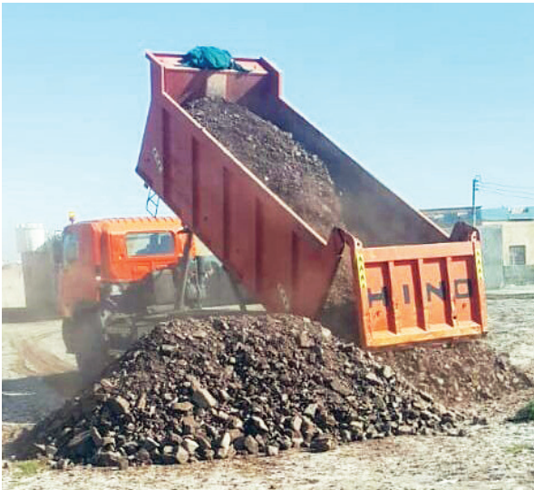
■ كبس مواقع تجمع مياه الأمطار بالحدة
