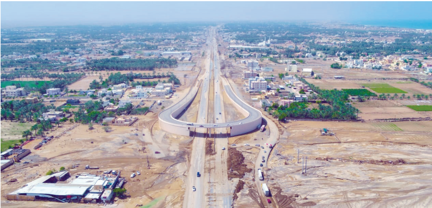
■ صورة جوية تظهر طريق الباطنة العام، حيث تم إصلاح الكثير من الطرق المتأثرة.
