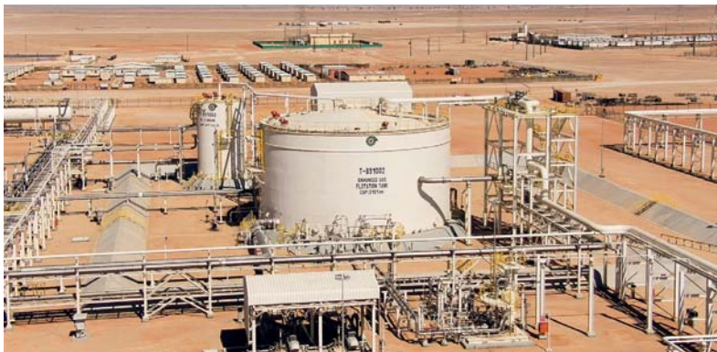
محطة تجميع الإنتاج في منطقة صقر الكبرى تسهم في خفض نحو ٦٦٠٠ طن من مكافئ ثاني أكسيد الكربون سنوياً
