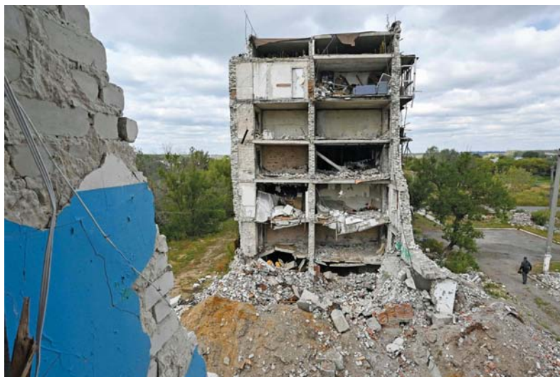
■ مبنى سكني دُمِّر بفعل القصف في بلدة إيزيوم بمنطقة خاركييف في أوكرانيا
