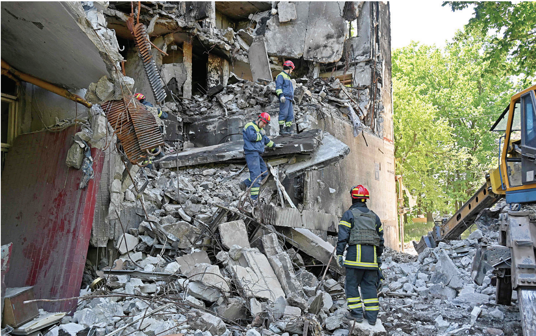
■ عمال الإنقاذ يفككون أنقاض مبنى سكني دمر جزئياً بسبب القصف على المشارف الشمالية لثاني أكبر مدينة أوكرانية في خاركيف أمس.
