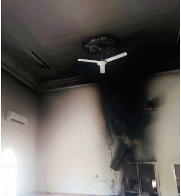
■ من الآثار التي خلفها الحريق
