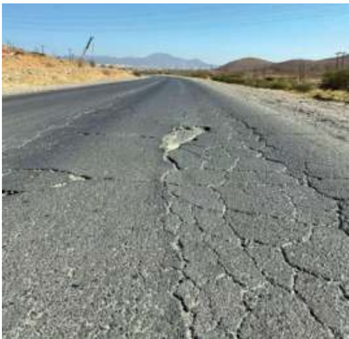
■ التشققات والتعرجات والحفر وتعد المداخل والخارج بالطريق تتسبب في وقوع حوادث مرورية.
