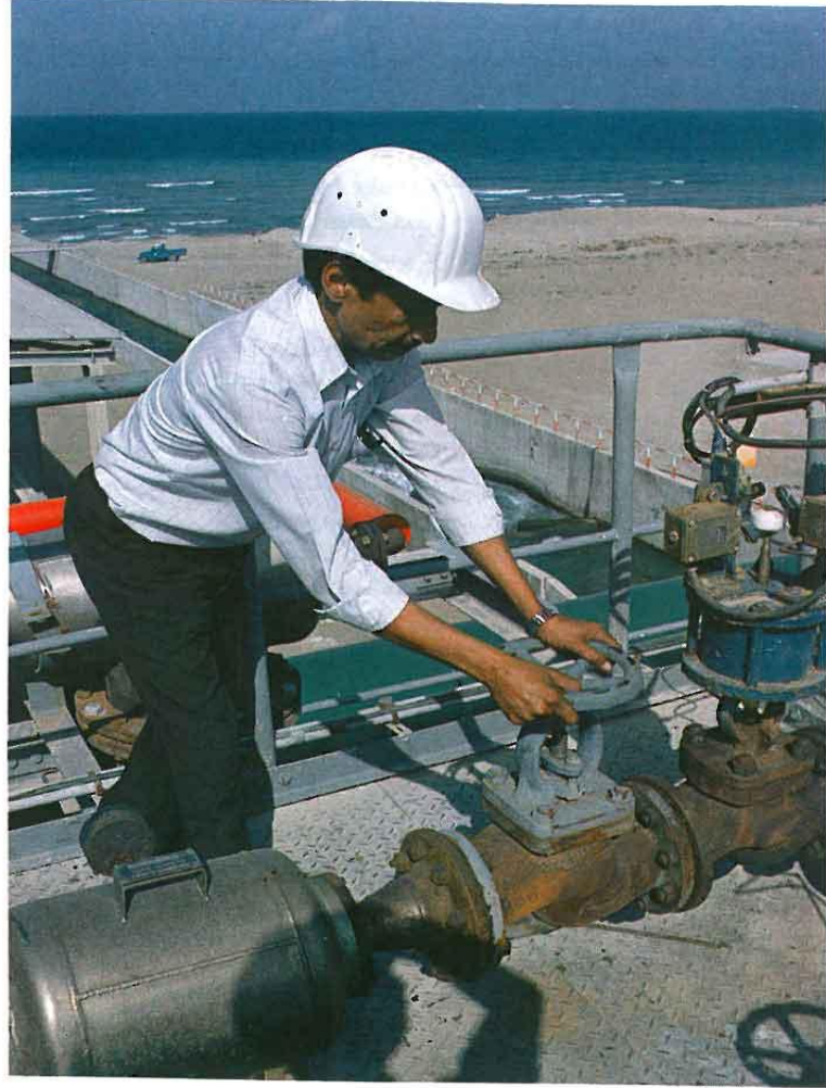
مياه عذبة لمنطقة العاصمة - محطة الغبرة لتنقية المياه
