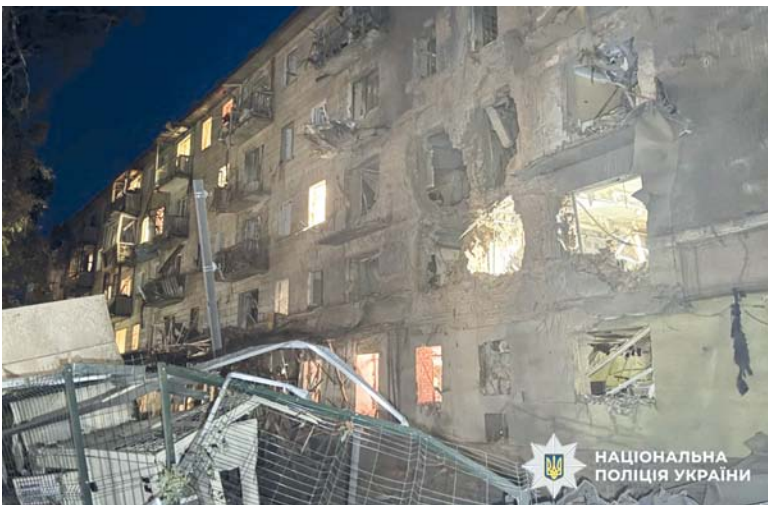
■ مبنى سكني تضرر جراء هجوم جوي روسي في مدينة سومي
