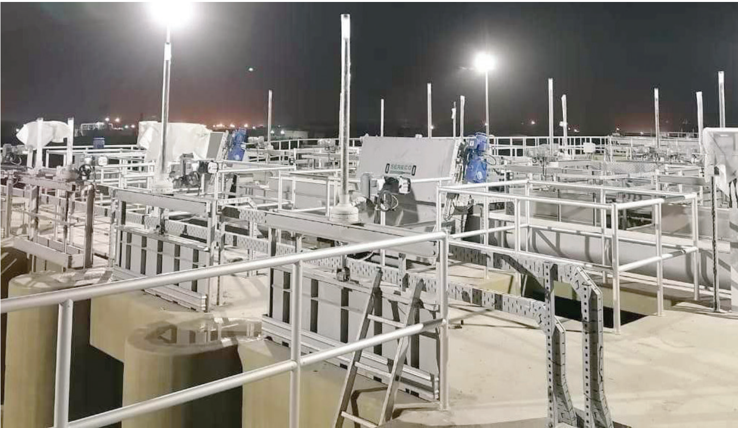
■ محطة معالجة الصرف الصحي بريسوت
