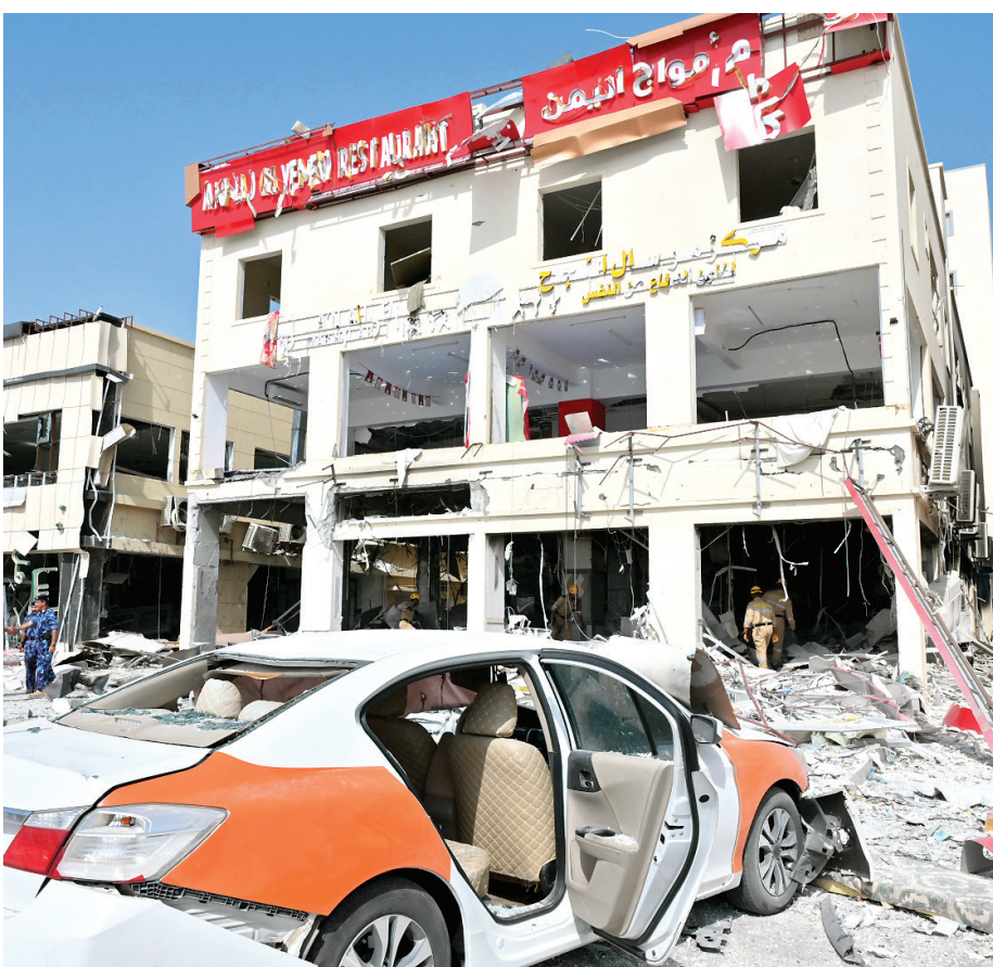
«تصوير- فيصل البلوشي» المبنى الذي وقع فيه انفجار أسطوانة الغاز في المعبيلة أمس
