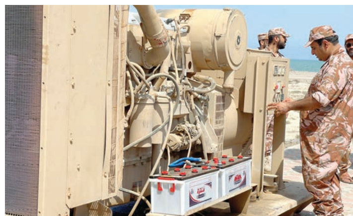
الخدمات الهندسية خلال تركيب مولدات الطاقة الكهربائية
