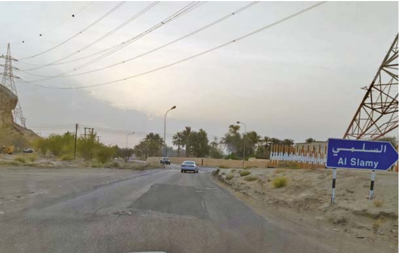
■ الطريق مليء بالحفر والتشققات الإسفلتية
