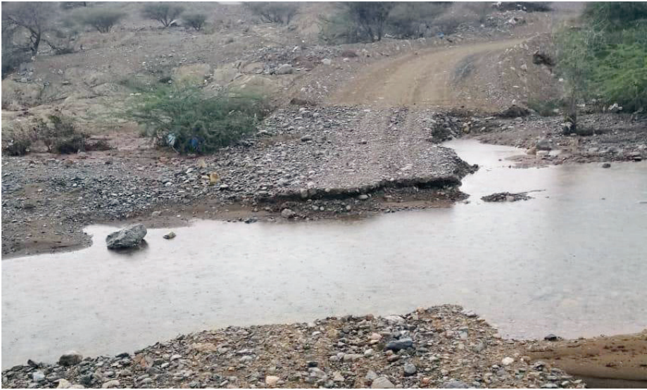
صورة أرشيفية توضح انقطاع الطريق بشكل كامل أثناء هبوط الأودية
