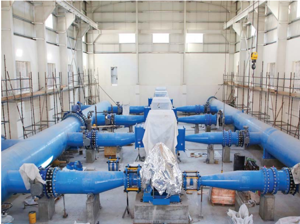
■ محطة ضخ المياه
